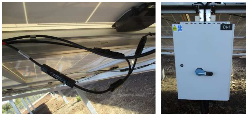
Exemple de câble électrique et de boîte de raccordement
